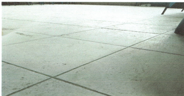
Foto: 1 Piso cerámico en una de las aulas 100%
